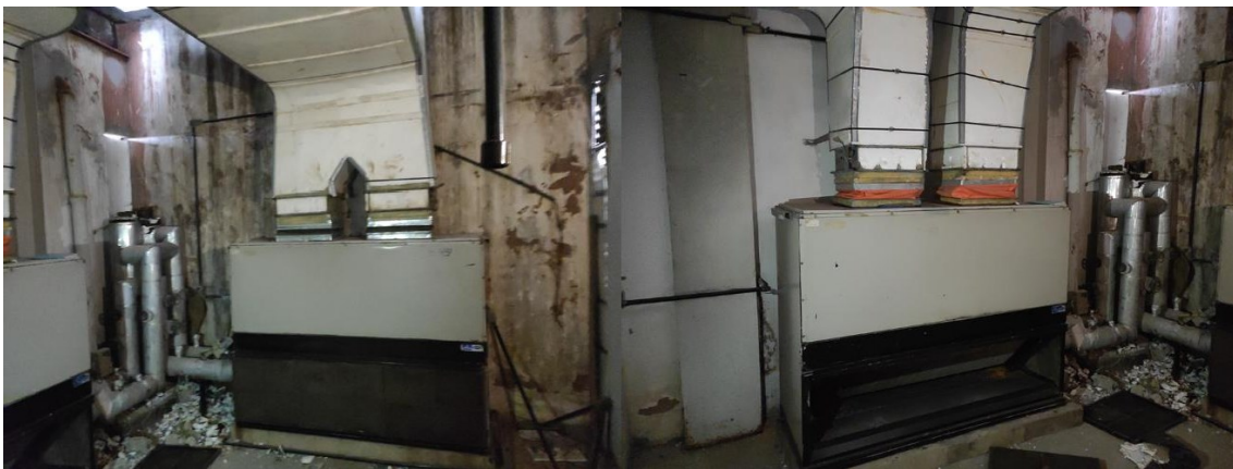
FOTO 10 – Casa de máquinas 1 2º Pav. – Centrais da 1º C.M do 2 pavimento, ambas são de 20 TR.
