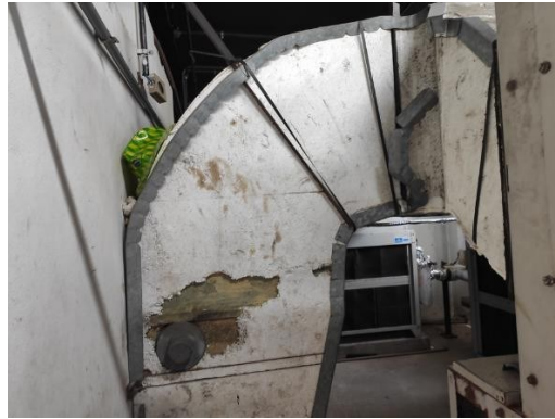
FOTO 8 – C.M 2 – Trecho de isolamento de duto de uma das centrais da C.M 2 danificados.
