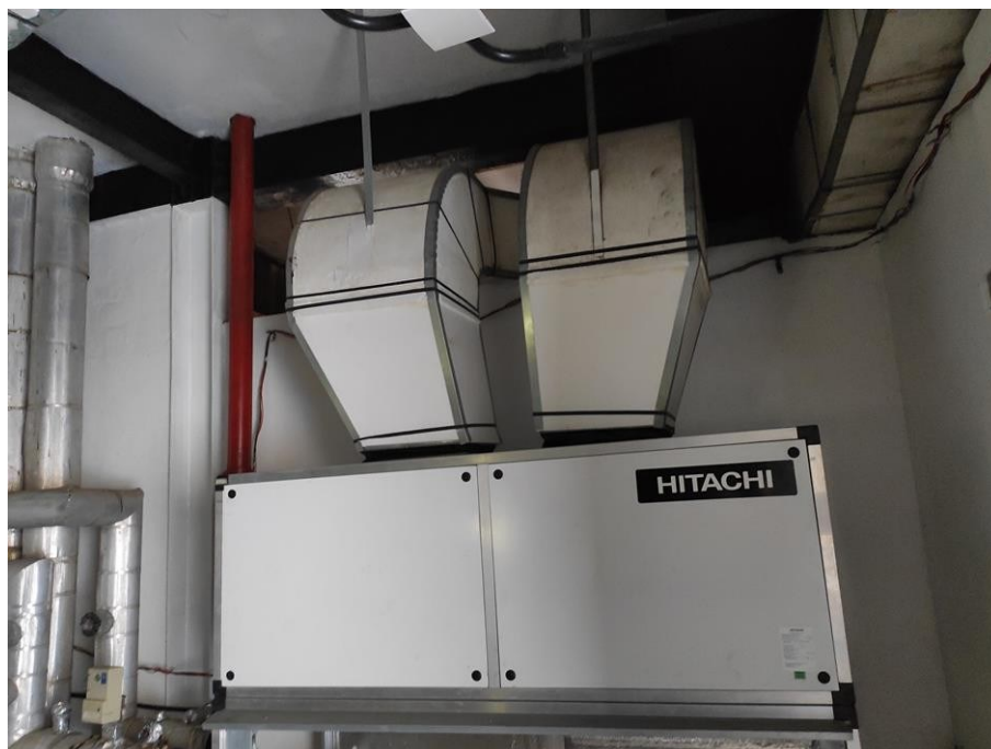
FOTO 14 – C.M 2 1° PAV. – Central encontra-se com os dutos e o isolamento em boas condições.
