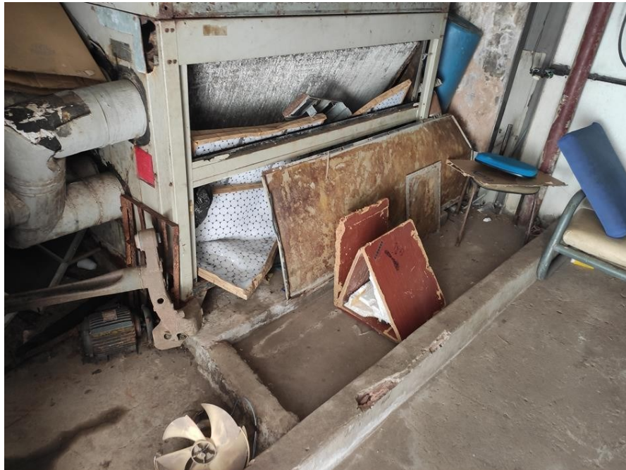
FOTO 4 – C.M 1 – Casa de máquinas deve ser devidamente nivelada assim como terá seu espaço limpo e livre de objetos avulsos próximo a central.
