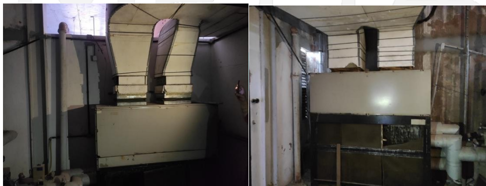
FOTO 15 – Casa de máquinas 2 2° Pav- Ambas as centrais são de 20 TR e encontram-se com os dutos em boas condições.
