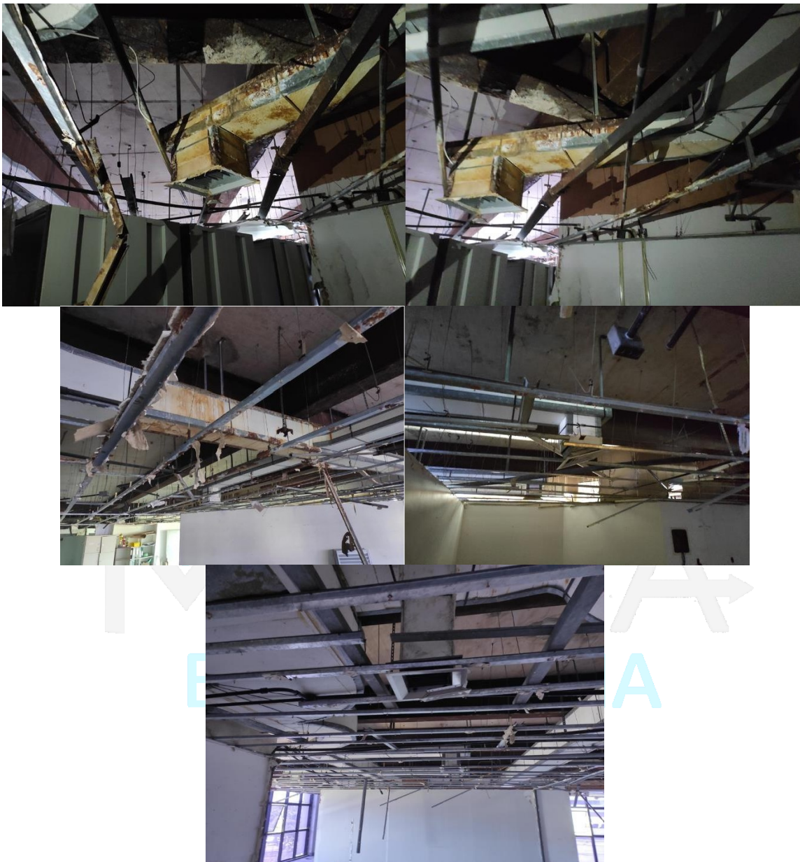
FOTO 9 – 2° Pav. – Trecho de dutos de insuflamento do 2° Pav. Deverá ser refeito, pois o mesmo encontra-se danificado e bastante deteriorado assim como a troca dos difusores danificados.
