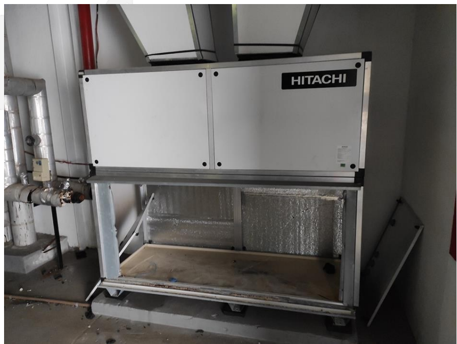
FOTO 13 – C.M 2 1° PAV. – Central encontra-se sem as serpentinas e precisa ser trocada.
