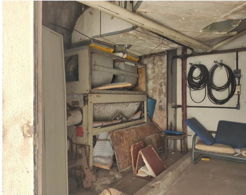
FOTO 2 – C.M 1 Térreo – Dutos da central de ar que será trocada e seu isolamento térmico refeito.
