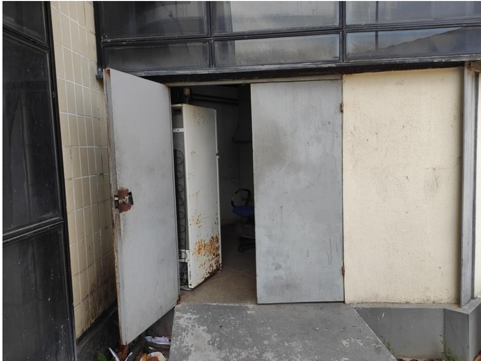
FOTO 6 – Casa de Máquina 2 (C.M 2) - Térreo.
