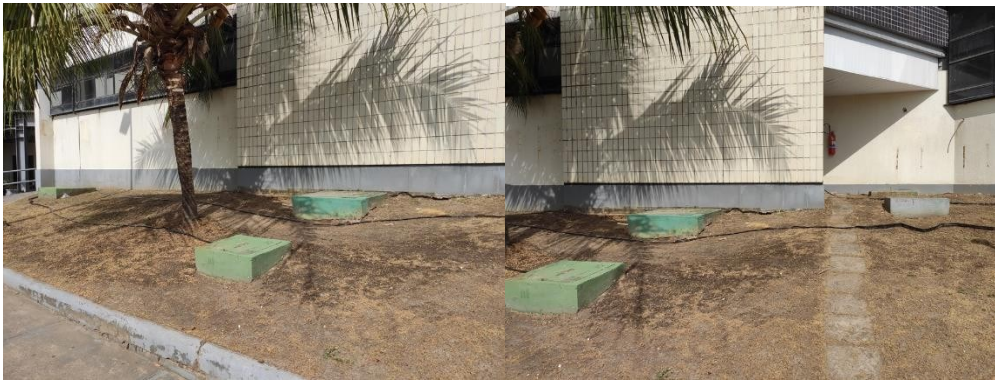
FOTO 5 – C.M 1 – Local que será destinado as condensadoras próxima a C.M 1 do térreo.
