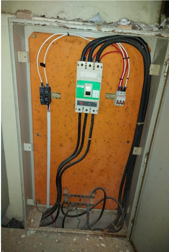
FOTO 33 – QFAC – Será substituído o QFAC.
