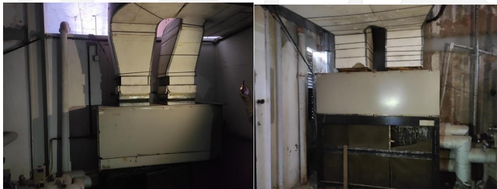
FOTO 15 – Casa de máquinas 2 2° Pav- Ambas as centrais são de 20 TR e encontram-se com os dutos em boas condições.
