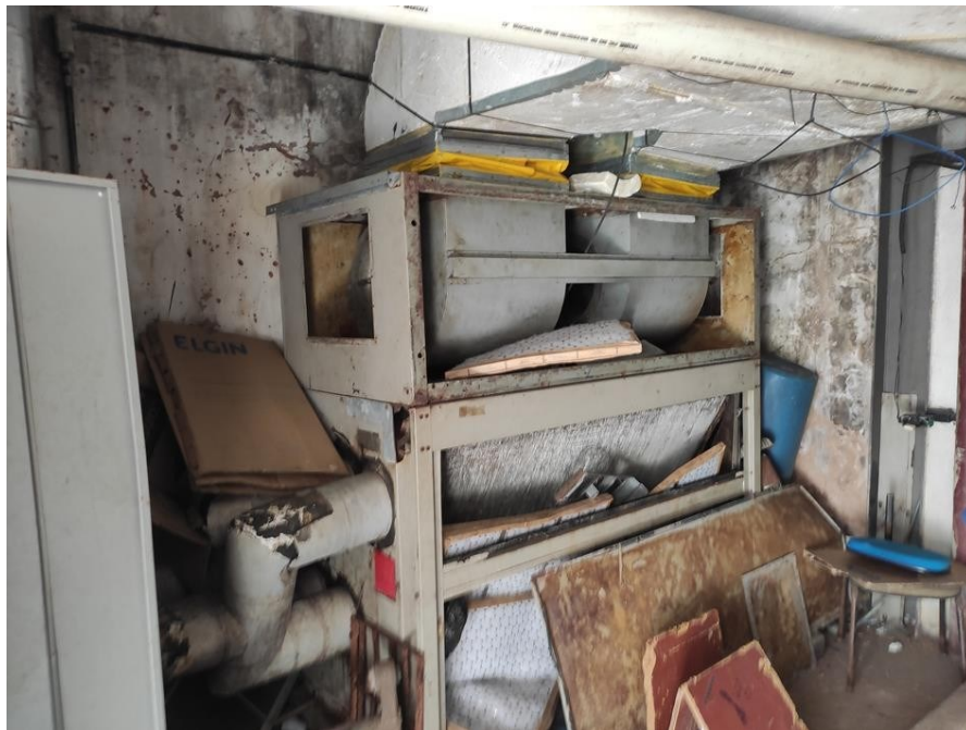
FOTO 1 – CASA DE MÁQUINAS 1 (C.M 1) TÉRREO – 1 central de 15 TR.
