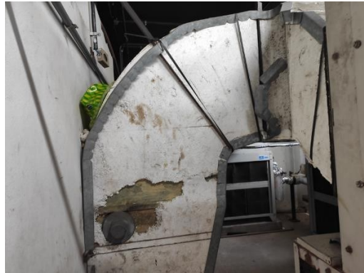
FOTO 8 – C.M 2 – Trecho de isolamento de duto de uma das centrais da C.M 2 danificados.
