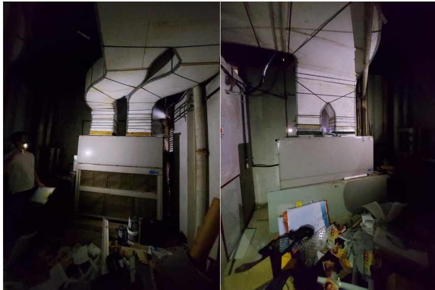
FOTO 12 – C.M 1 1° PAV – Centrais da C.M 2 do 1° Pav. ambas são de 15 TR
