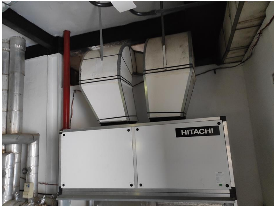
FOTO 14 – C.M 2 1° PAV. – Central encontra-se com os dutos e o isolamento em boas condições.
