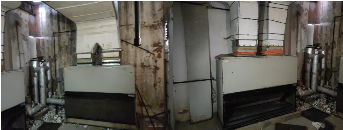
FOTO 10 – Casa de máquinas 1 2º Pav. – Centrais da 1º C.M do 2 pavimento, ambas são de 20 TR.
