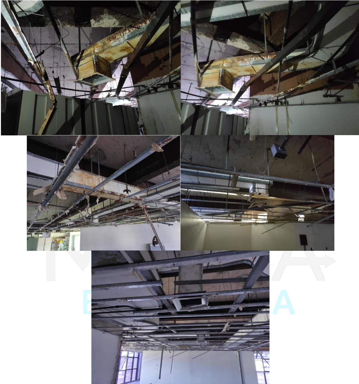
FOTO 9 – 2° Pav. – Trecho de dutos de insuflamento do 2° Pav. Deverá ser refeito, pois o mesmo encontra-se danificado e bastante deteriorado assim como a troca dos difusores danificados.
