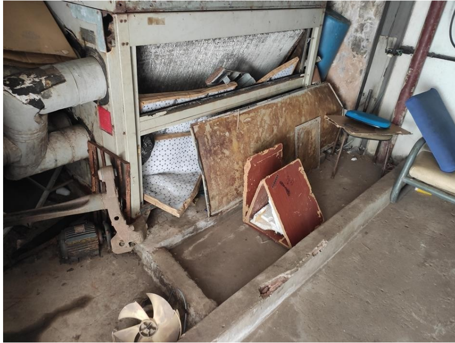
FOTO 4 – C.M 1 – Casa de máquinas deve ser devidamente nivelada assim como terá seu espaço limpo e livre de objetos avulsos próximo a central.
